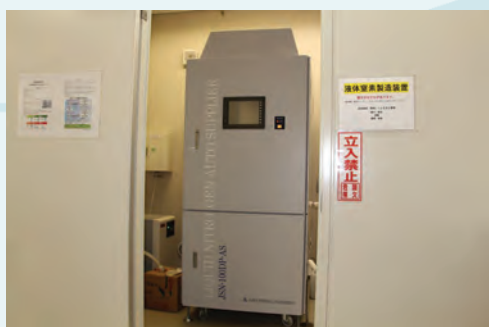
液体窒素自動供給装置 JSN-100DP-AS (日本サーマル エンジニアリング)
